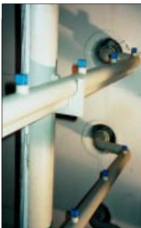
Détail du système de buses de pulvérisation
